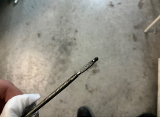
Motor, Yağ seviyesi > Eksik
