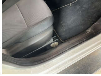
Döşemeler/Kapaklar, Döşemeler/Kapaklar > Kirlenmiş
