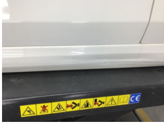
Marşbiyel, sağ, Marşbiyel, sağ > Hasarlı
