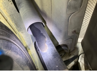
Arka aks, Amortisör, arka sol > Yağ Kaçağı
