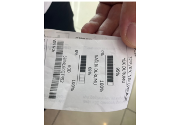
Elektrik donanımı/Pano, Akü > Test Sonucu
