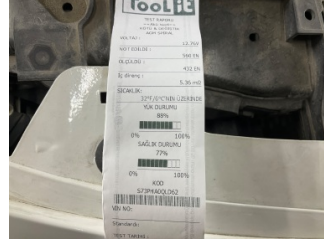
Elektrik donanımı/Pano, Akü > Test Sonucu
