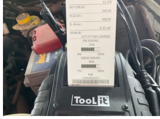
Elektrik donanımı/Pano, Akü > Test Sonucu
