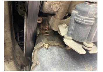
Motorsoğutması, Soğutma sıvısı > Sızdırıyor
