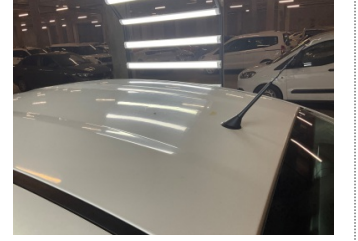
Tavan, Tavan > Dolu Hasarı
