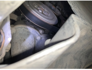
Motor, Motor > Yağ Kaçağı
