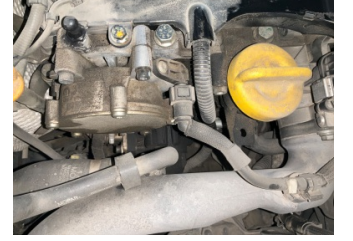
Motor, Motor > Yağ Kaçağı
