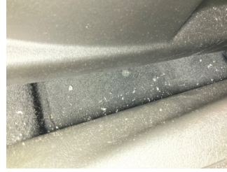
Döşemeler/Kapaklar, Döşemeler/Kapaklar > Yakıcı Madde Ile Zarar Görmüş
