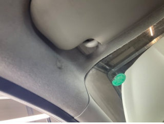
Döşemeler/Kapaklar, Döşemeler/Kapaklar > Yakıcı Madde Ile Zarar Görmüş
