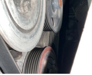
Motorsoğutması, Kayış > Çatlak
