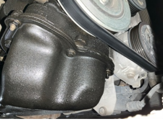
Motor, Motor > Yağ Kaçağı
