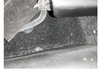
Döşemeler/Kapaklar, Döşemeler/Kapaklar > Yakıcı Madde Ile Zarar Görmüş
