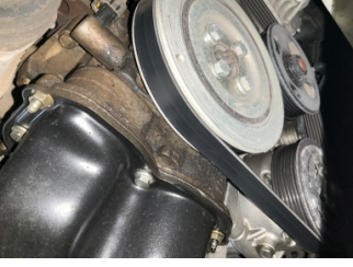
Motor, Motor > Yağ Kaçağı
