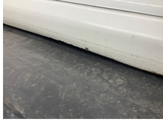
Marşbiyel, sağ, Marşbiyel, sağ > Boyası Atmış
