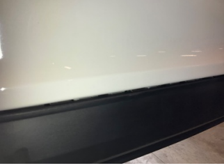
Tampon, arka, Spoiler > Sabitlemesi Hatalı
