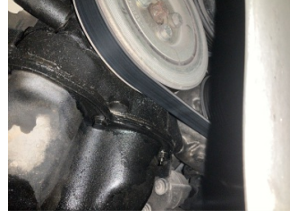
Motor, Motor > Yağ Kaçağı
