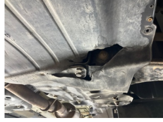
Motor, Alt muhafaza > Hasarlı
