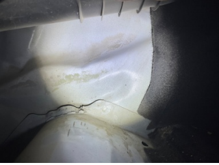
Arka bölüm, Arka sac/panel > Hasarlı
