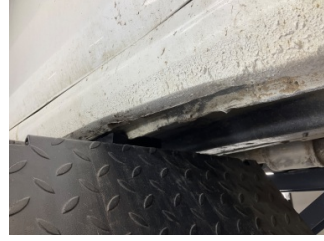
Marşbiyel, sağ, Marşbiyel, sağ > Hasarlı
