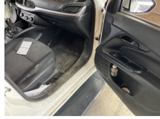
Döşemeler/Kapaklar, Döşemeler/Kapaklar > Deforme Olmuş
