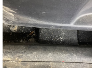
Döşemeler/Kapaklar, Döşemeler/Kapaklar > Yakıcı Madde Ile Zarar Görmüş
