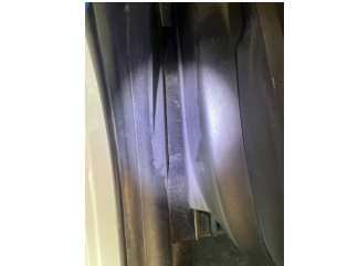
Döşemeler/Kapaklar, Döşemeler/Kapaklar > Yakıcı Madde ile Zarar Görmüş
