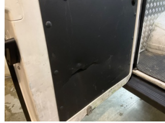
Döşemeler/Kapaklar, Döşemeler/Kapaklar > Hasarlı
