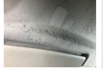
Döşemeler/Kapaklar, Döşemeler/Kapaklar > Kirlenmiş
