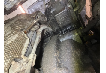
Motor, Motor > Yağ Kaçağı
