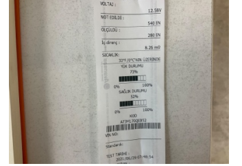
Elektrik donanımı/Pano, Akü > Test Sonucu
