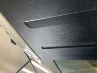
Döşemeler/Kapaklar, Döşemeler/Kapaklar > Çizik
