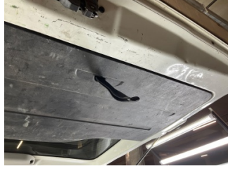
Döşemeler/Kapaklar, Döşemeler/Kapaklar > Hasarlı
