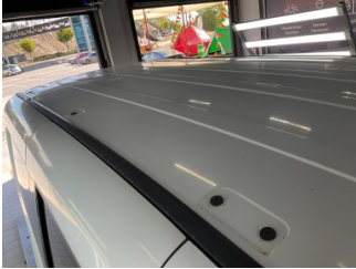
Tavan, Tavan > Dolu Hasarı
