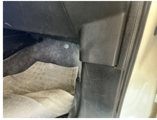
Döşemeler/Kapaklar, Döşemeler/Kapaklar > Sabitlemesi Hatalı
