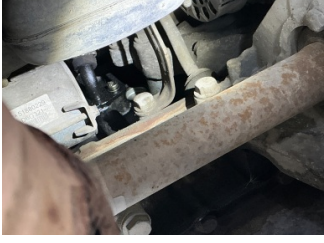
Motor, Motor > Yağ Kaçağı
