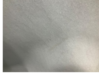
Döşemeler/Kapaklar, Döşemeler/Kapaklar > Kirlenmiş
