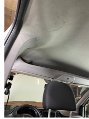
Döşemeler/Kapaklar, Döşemeler/Kapaklar > Çizik
