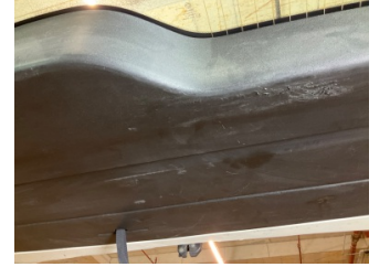
Döşemeler/Kapaklar, Döşemeler/Kapaklar > Çizik
