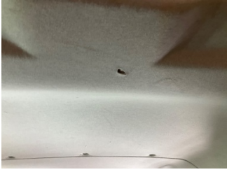
Döşemeler/Kapaklar, Tavan döşemesi > Hasarlı
