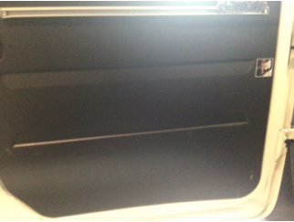
Döşemeler/Kapaklar, Döşemeler/Kapaklar > Çizik
