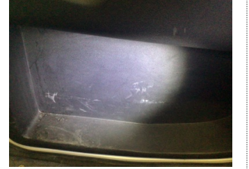
Döşemeler/Kapaklar, Döşemeler/Kapaklar > Çizik
