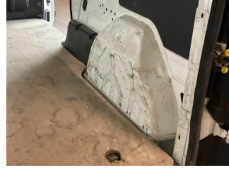
Döşemeler/Kapaklar, Döşemeler/Kapaklar > Hasarlı
