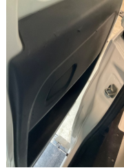
Döşemeler/Kapaklar, Döşemeler/Kapaklar > Çizik
