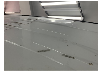
Tavan, Tavan > Hasarlı
