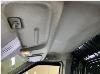
Döşemeler/Kapaklar, Döşemeler/Kapaklar > Kirlenmiş
