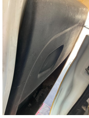
Döşemeler/Kapaklar, Döşemeler/Kapaklar > Çizik
