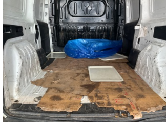
Döşemeler/Kapaklar, Döşemeler/Kapaklar > Deforme Olmuş
