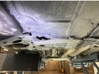
Motor, Alt muhafaza > Hasarlı
