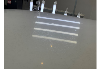
Tavan, Tavan > Dolu Hasarı
