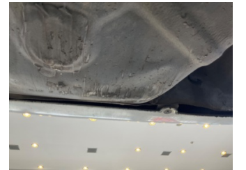
Arka bölüm, Bagaj havuzu > Hasarlı
