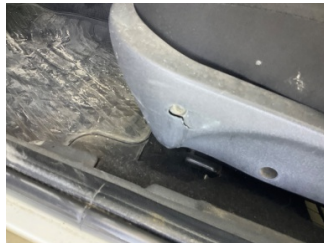
Döşemeler/Kapaklar, Döşemeler/Kapaklar > Hasarlı
