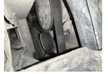
Motorsoğutması, Kayış > Çatlak
