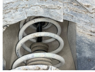
Ön aks, Amortisör körüğü, sol > Hasarlı
