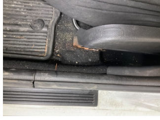
Döşemeler/Kapaklar, Döşemeler/Kapaklar > Yakıcı Madde ile Zarar Görmüş
