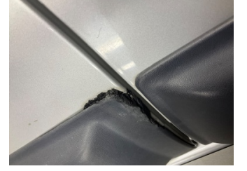
Kapı, sağ arka, Kapı bandı > Sabitlemesi Hatalı
