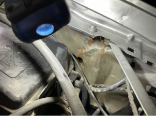
Kaporta, Sol Kılıç Sacı > Hasarlı
