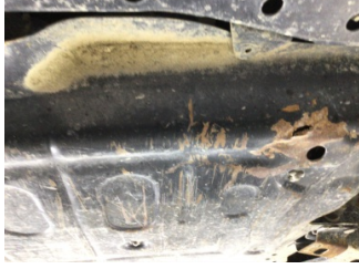
Motor, Alt muhafaza > Hasarlı
