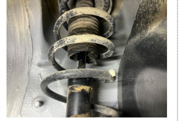
Arka aks, Amortisör körüğü, sol > Hasarlı
