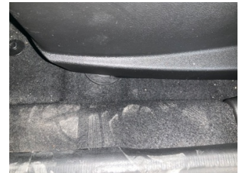
Döşemeler/Kapaklar, Döşemeler/Kapaklar > Yakıcı Madde Ile Zarar Görmüş
