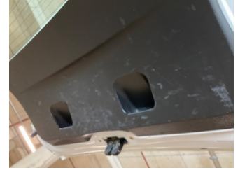
Döşemeler/Kapaklar, Döşemeler/Kapaklar > Çizik
